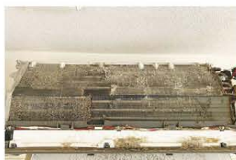
▲エアコン、熱交換器の汚れ
